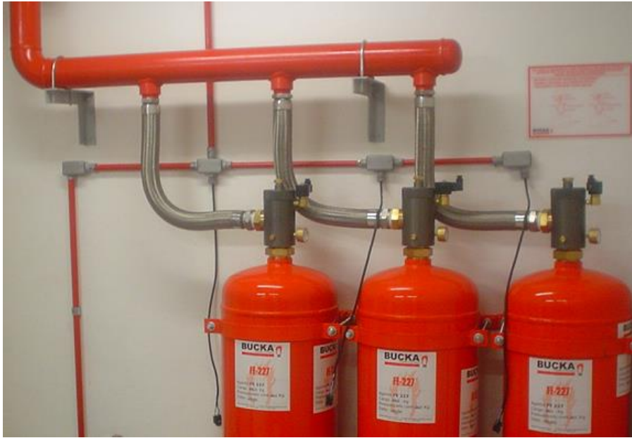
Bateria de cilindros e atuadores
